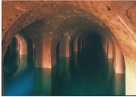
El depósito de Montsouris, en el sur de París, es uno de los lugares donde la capital almacena, intramuros, su agua potable. EAU DE PARIS
